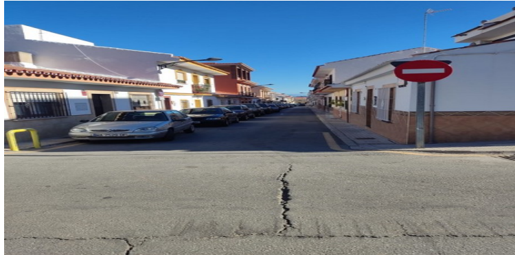
Fotografía 2. Vista del estado actual del cruce Avda de las Palmeras con C/ Severo Ochoa.
